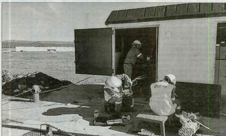
POLÍGONO INDUSTRIAL. Tres técnicos trabajan en un centro de transformación en Las Calañas.
